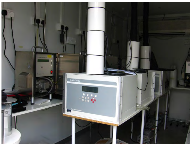
Abbildung 8: Messgeräte BAM-1020 in Messstation (2 Prüflinge aus Eignungsprüfung + 1 Prüfling zu Versuchszwecken (Heizungskonfiguration))
