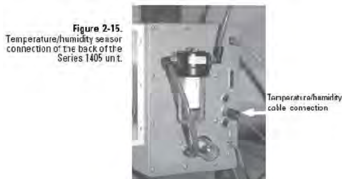
Anschluss des Temperatur-/Feuchtigkeitssensors auf der Rückseite des TEOM 1405-F.
