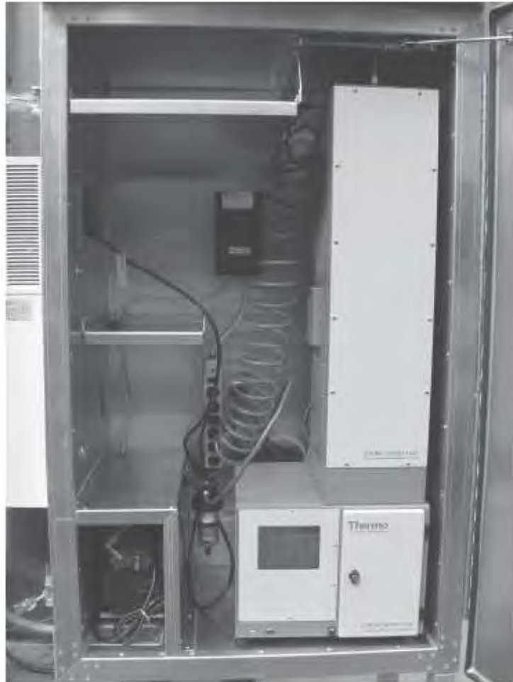
Messgerät im Schutzgehäuse für Betrieb im Freien
