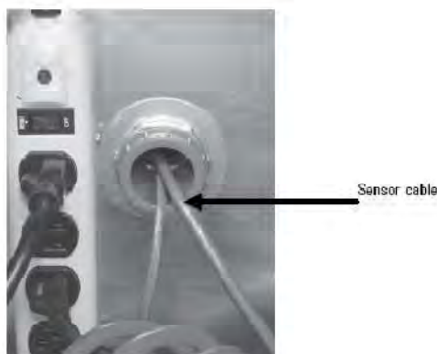
Kabel des Temperatur-/Feuchtigkeitssensors / Eintritt ins Gehäuse
