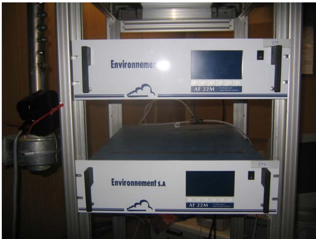
Abbildung 4: Frontaufnahme der im Messcontainer installierten Messeinrichtungen
