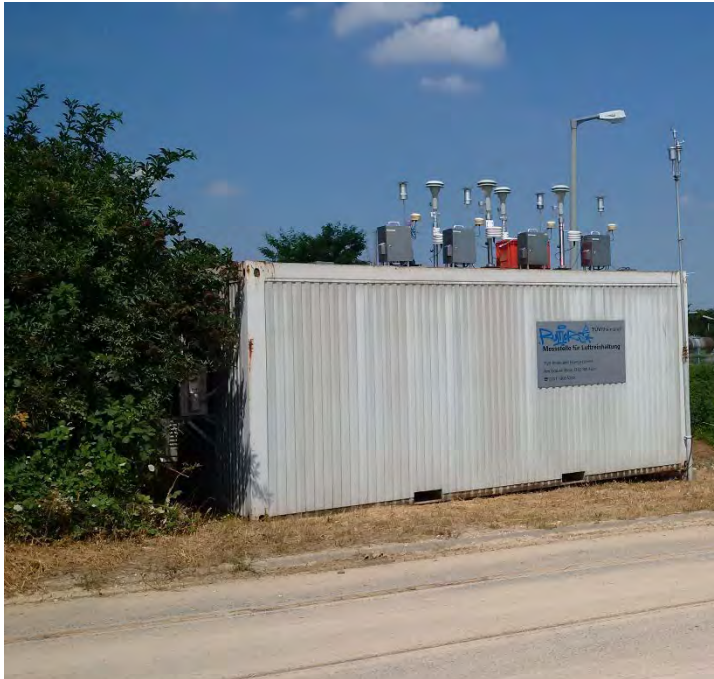
Abbildung 5: Messsysteme MP101M auf Messstation (Schüttgutumschlag)
